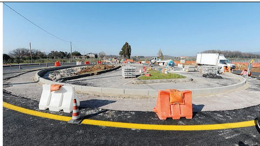
La rotatoria in costruzione a Vada tra la 206 e via della Torre
